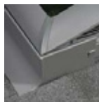
Diseño de cuña de esquina que encierra el peligro de agua percibido.
